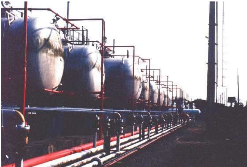
Foto 2 – Tanques de armazenamento de GLP
