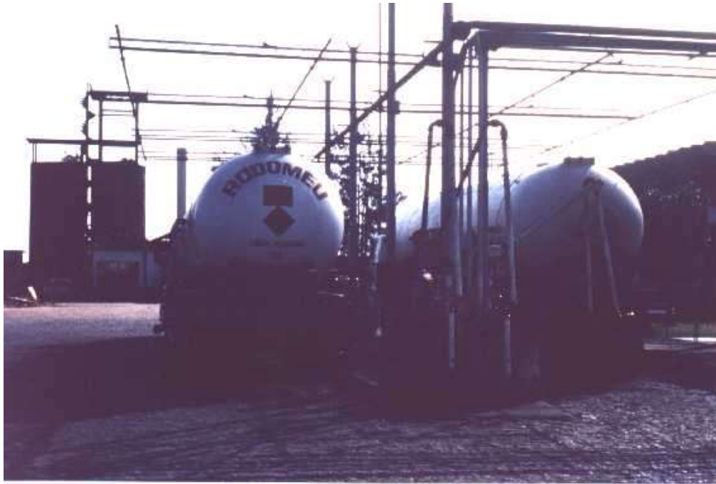
Foto 1 – Tanques de armazenamento de GLP
